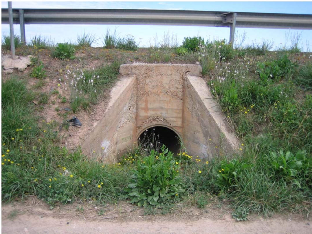
21. Drenaje actual de la CV32. La inspección visual indica que está obturado.
