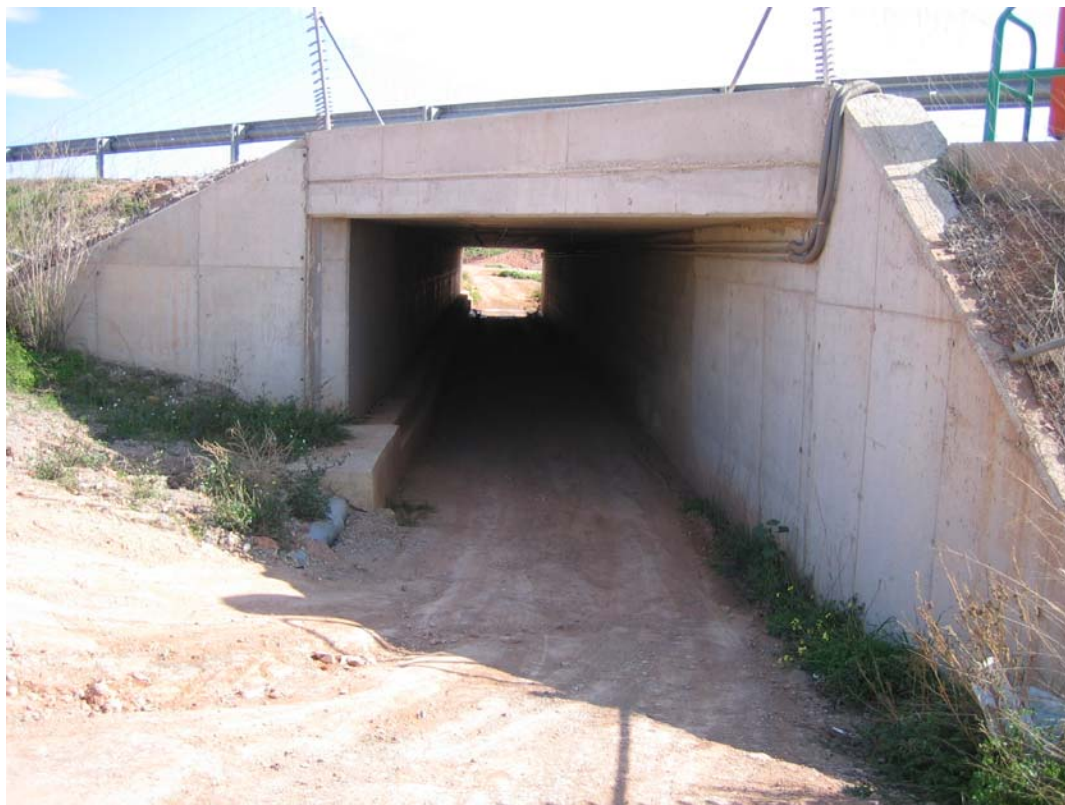
Estructura de drenaje transversal de la A7 en la zona de estudio
